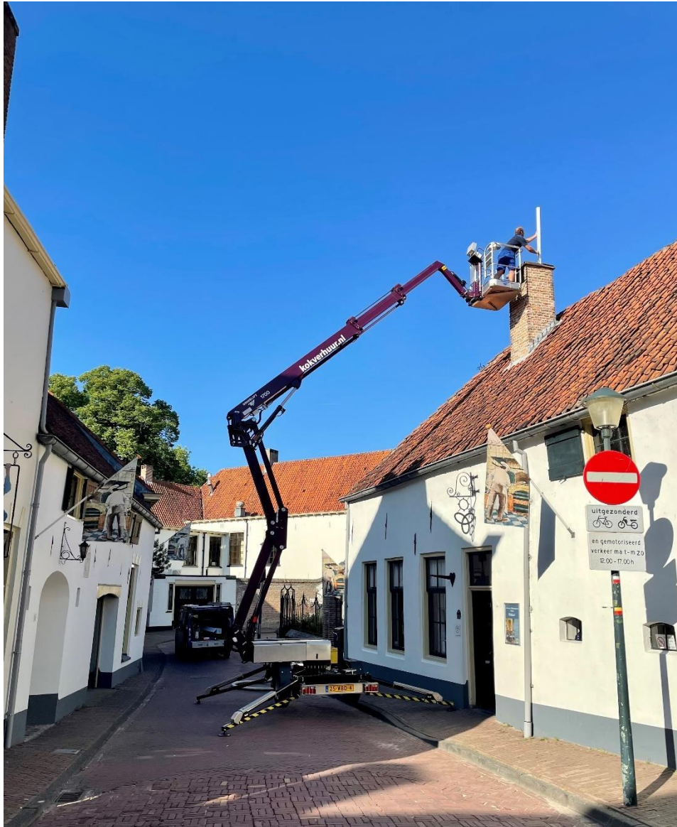
Een nieuwe ketel, een nieuwe schoorsteen.
